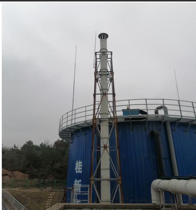
废气排气筒 DA001
