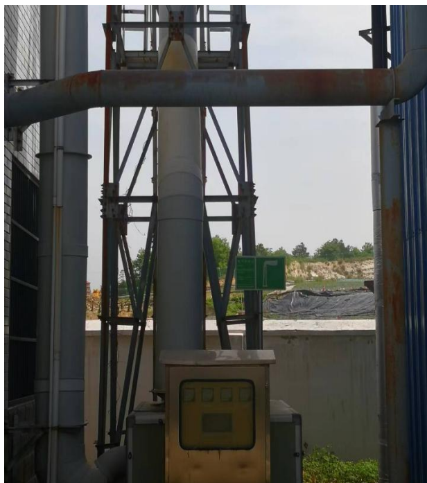
DA001 排气筒标识牌
