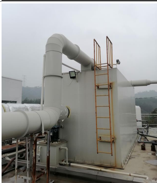
生物除臭系统
